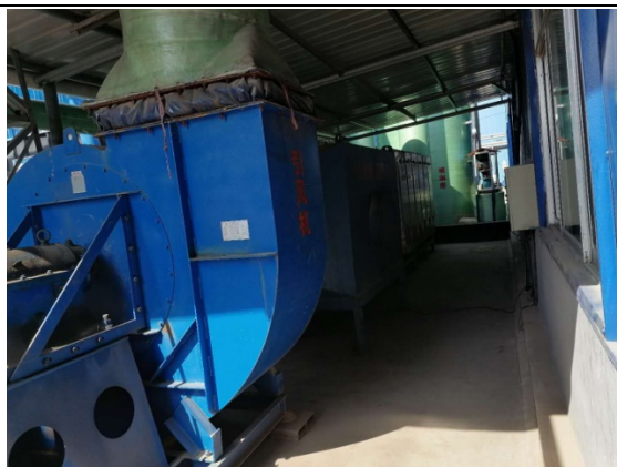
废气处理设施 (依托日照锦昌固体废物处置有限公司)
